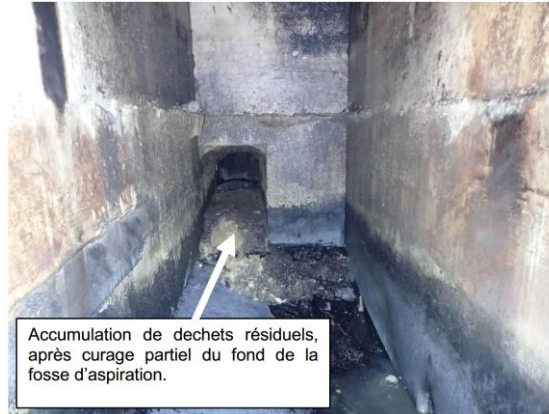
Photo de l'intérieur de la fosse d'aspiration
