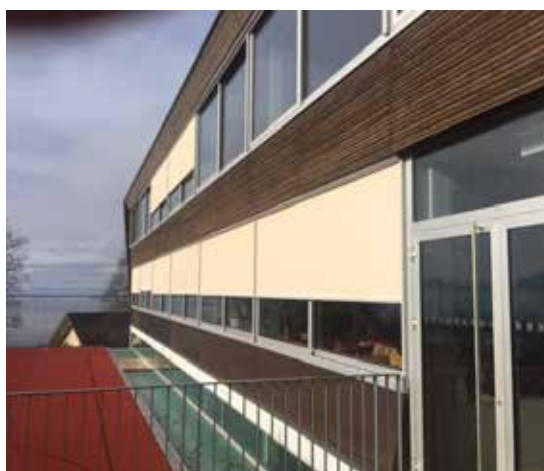
Complexe scolaire de La Croix/Lutry Remplacement des stores en toile sur la façade Est du bâtiment principal
