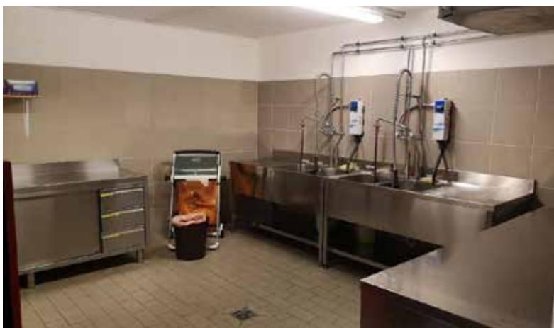
Nouveau local de nettoyage des APR à Lutry
