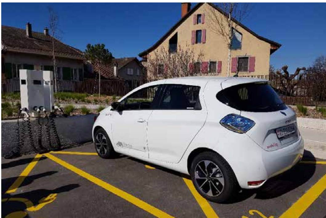
Borne de recharge du parking de la Possession
