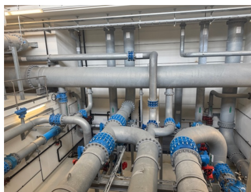
Figure 7 – « Aiguillage » de l'eau soit vers le réseau soit dans les réservoirs
