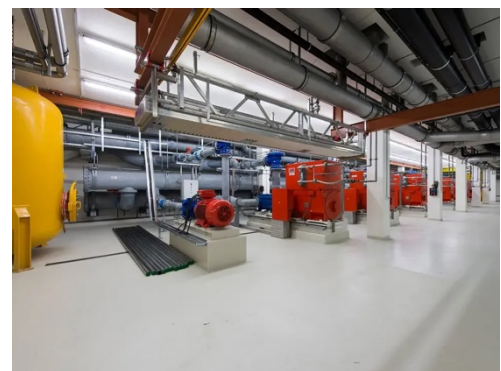
Figure 5 – Pompes d'envoi dans le réseau
