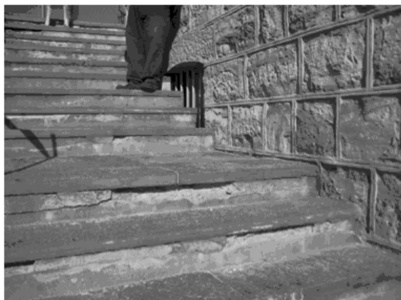
Collège de Savuit – Escalier d'accès avant la réfection
