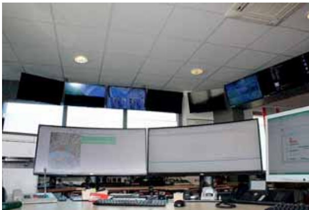
Nouvelle centrale d'engagement
