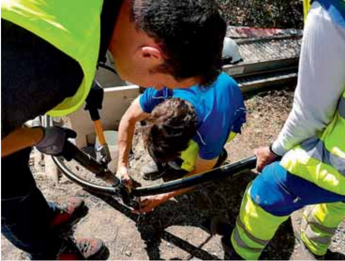
Dépose de la ligne aérienne à la Grangette : coupe du câble BT
