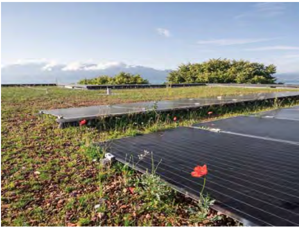
Panneaux photovoltaïques (toiture des Pâles 1)
